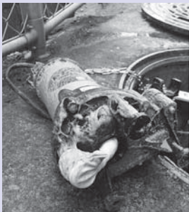
▲マンホールポンプに詰まった衣類
