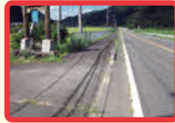
10 国道365号と合波橋の交差点 (段差あり危険)
