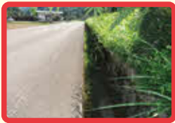
3 南今庄～下新道 (側溝深い・ラインなし)
